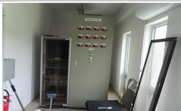
전기실 조작·제어반 상태양호
