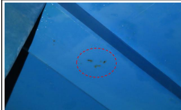
배수지 1지 상부슬래브 녹
