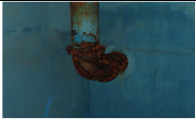
배수지 1지 오버플로우 배관 부식
