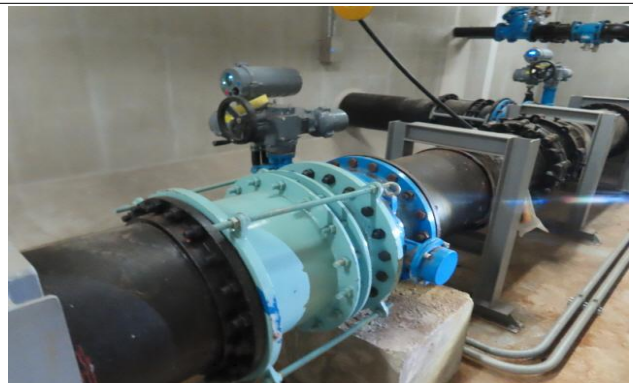
유입밸브실 배관 상태양호
