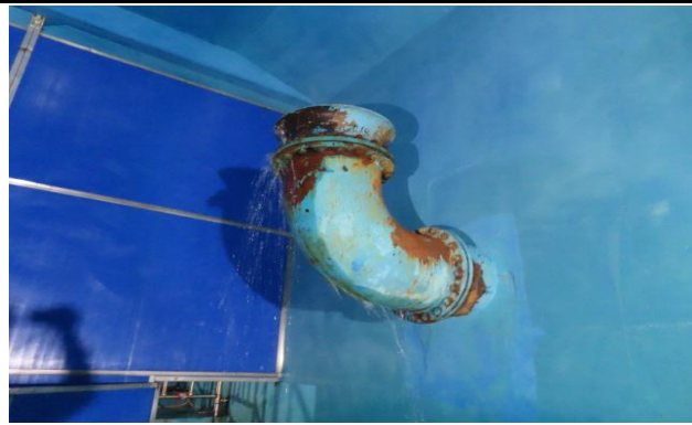
배수지 1지 유입 배관 도장손상
