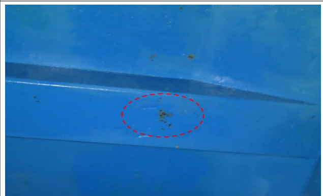
배수지 1지 상부슬래브 녹
