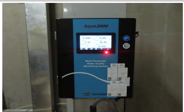
유출밸브실 조작·제어반 상태양호
