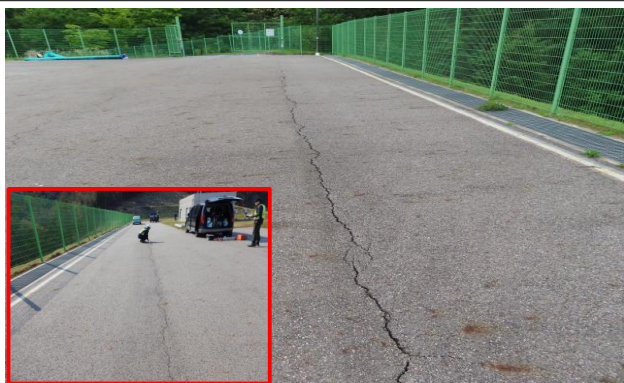
장내포장 아스콘 균열
