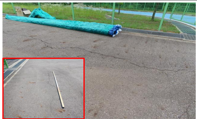
장내포장 아스콘 균열
